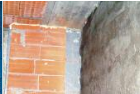
09_ Particolare disgiunzione tra muro divisorio e muro perimetrale
